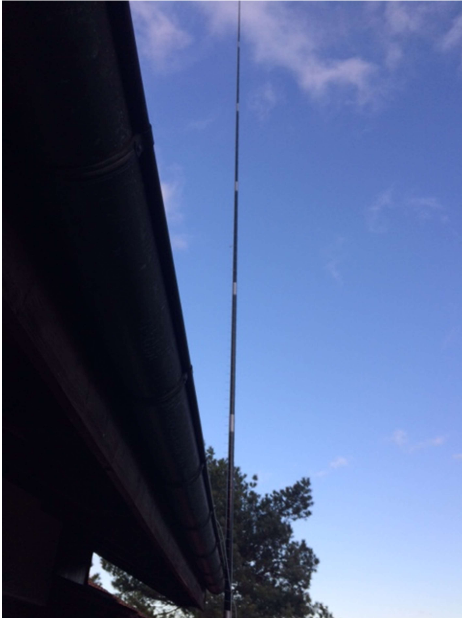
Abbildung 4 Helical 80m auf dem Balkon ausgefahren
